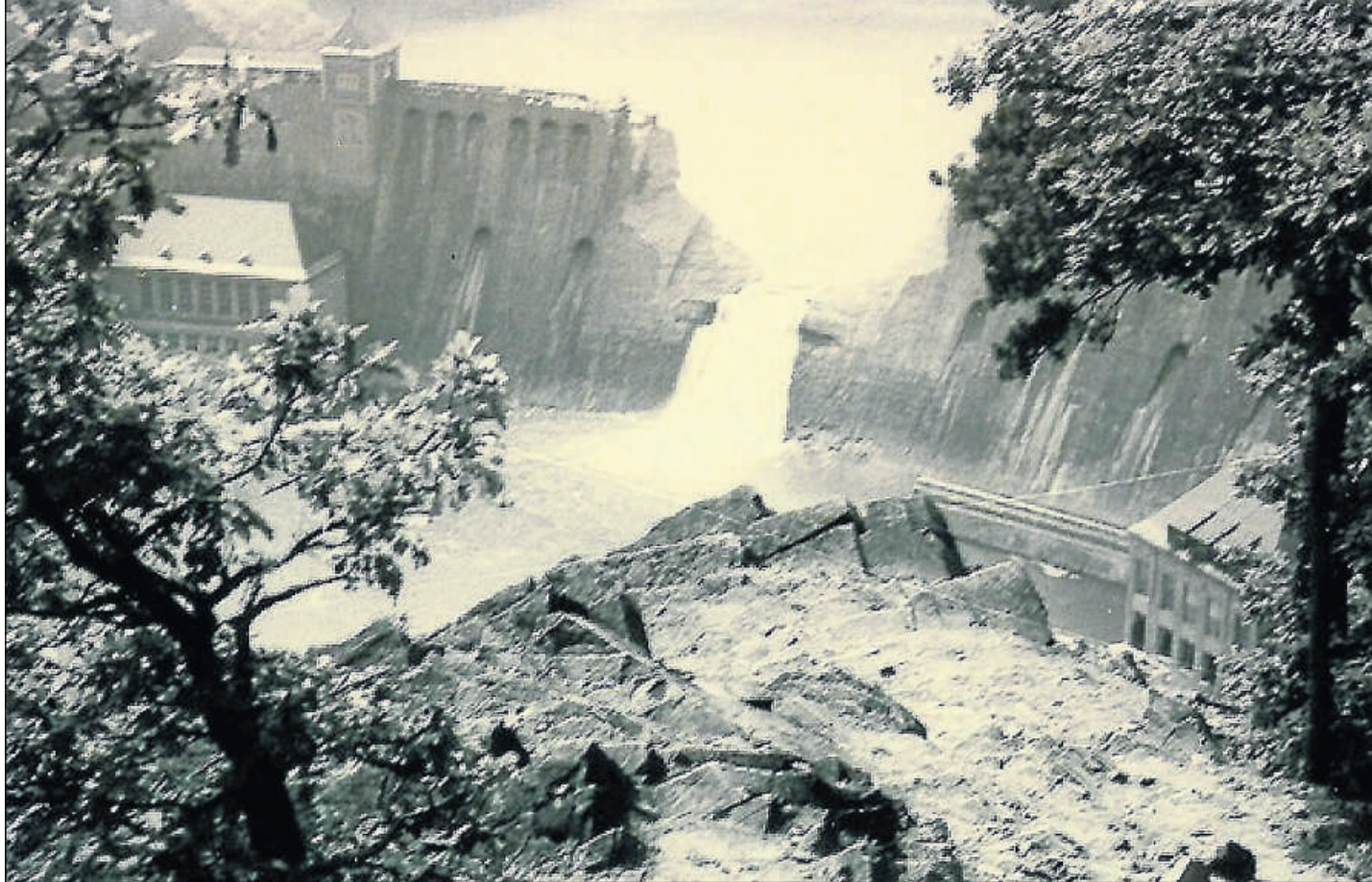
Luftangriff mit verheerenden Folgen für die Zivilbevölkerung: Die Detonation einer englischen Bombe riss am Morgen des 17. Mai 1943 ein Teilstück aus der Sperrmauer. Das halb ovale Loch war 60 Meter breit und 22 Meter tief. Foto/Reprofoto: Quellenmuseum Bad Wildungen/Klein
