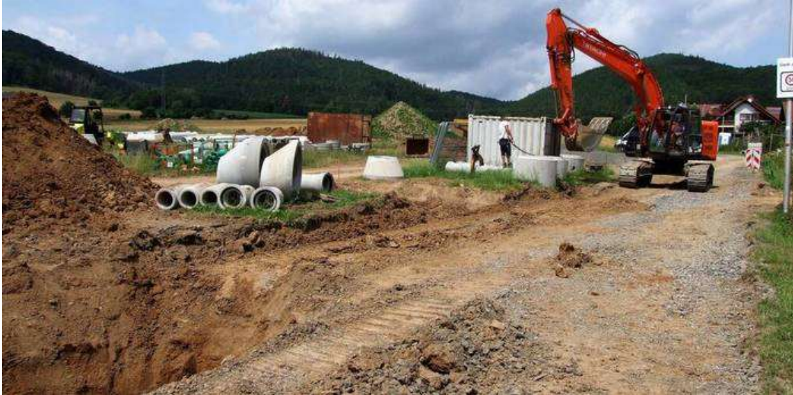
Gestiegene Nachfrage: Im Kleinerer Baugebiet „An den Dorfgärten“ ist die Erschließung im vollem Gang. Foto: Klein/pr
